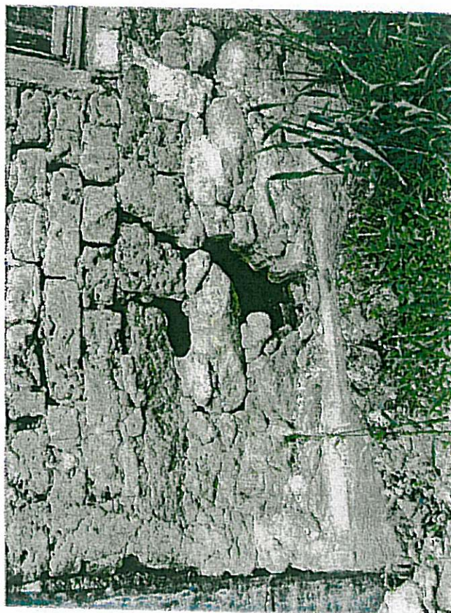
Uličná fasáda-zvetralé murivo
